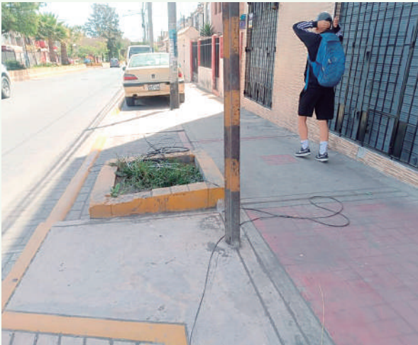
EN LA SEGUNDA CUADRA de la avenida Guardia Civil, en el distrito de Paucarpata, hay cables eléctricos expuestos en la vereda que ponen en riesgo la seguridad de los transeúntes.
